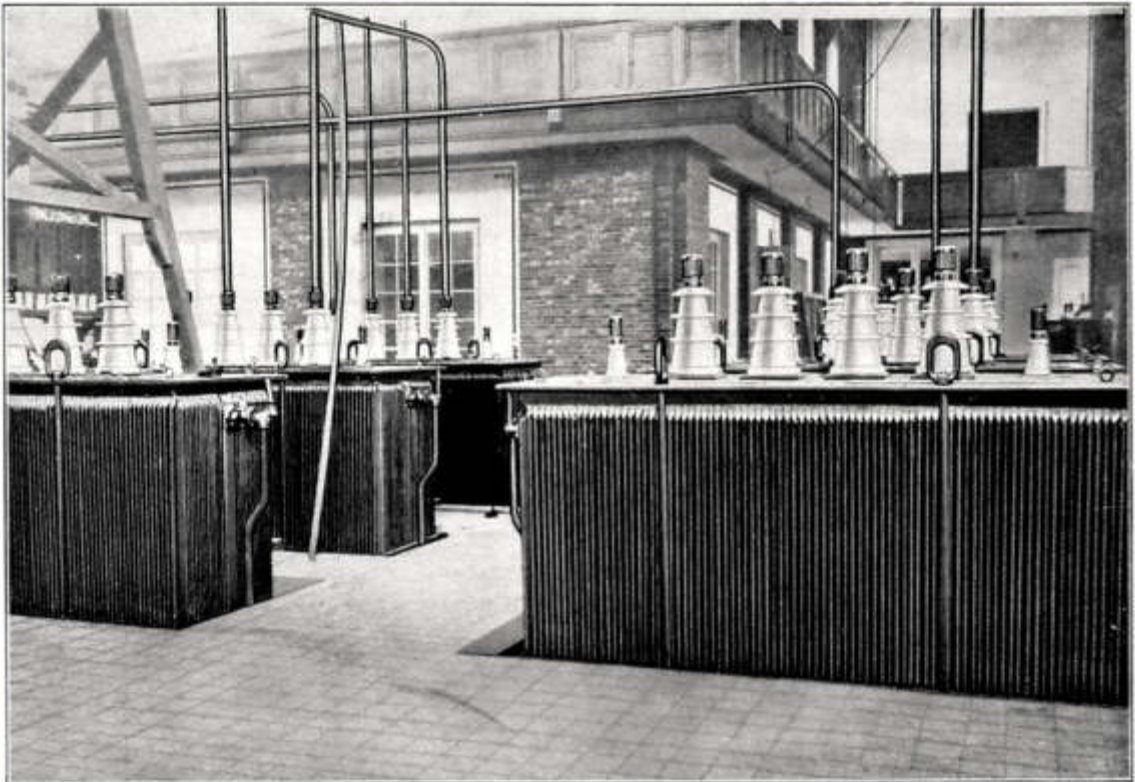
Bild 18. Frequenzwandler mit Tank. Ansicht.
