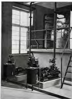
Bild 53. Teilansicht der Rückkühlanlage; die Kühlwasserpumpen.
