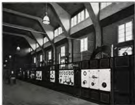
Bild 36. Die drei in einer Front von 25 m Länge aufgebauten Telephonie-Sender im Senderhaus 3.
