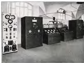
Bild 12. Zweiter 10 kW Telefunken-Röhrensender im Senderhaus I.
